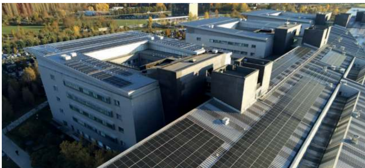
L'IMPIANTO FOTOVOLTAICO DA 300 KW DELL'OSPEDALE DI BERGAMO REALIZZATO DA RESIT
