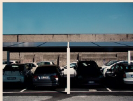
pensilina fotovoltaica per un parcheggio aziendale a Roma in zona Ostiense
