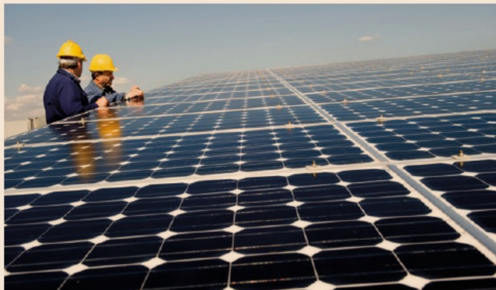
impianto fotovoltaico sulla copertura di un edificio nella zona dell'EUR a Roma
